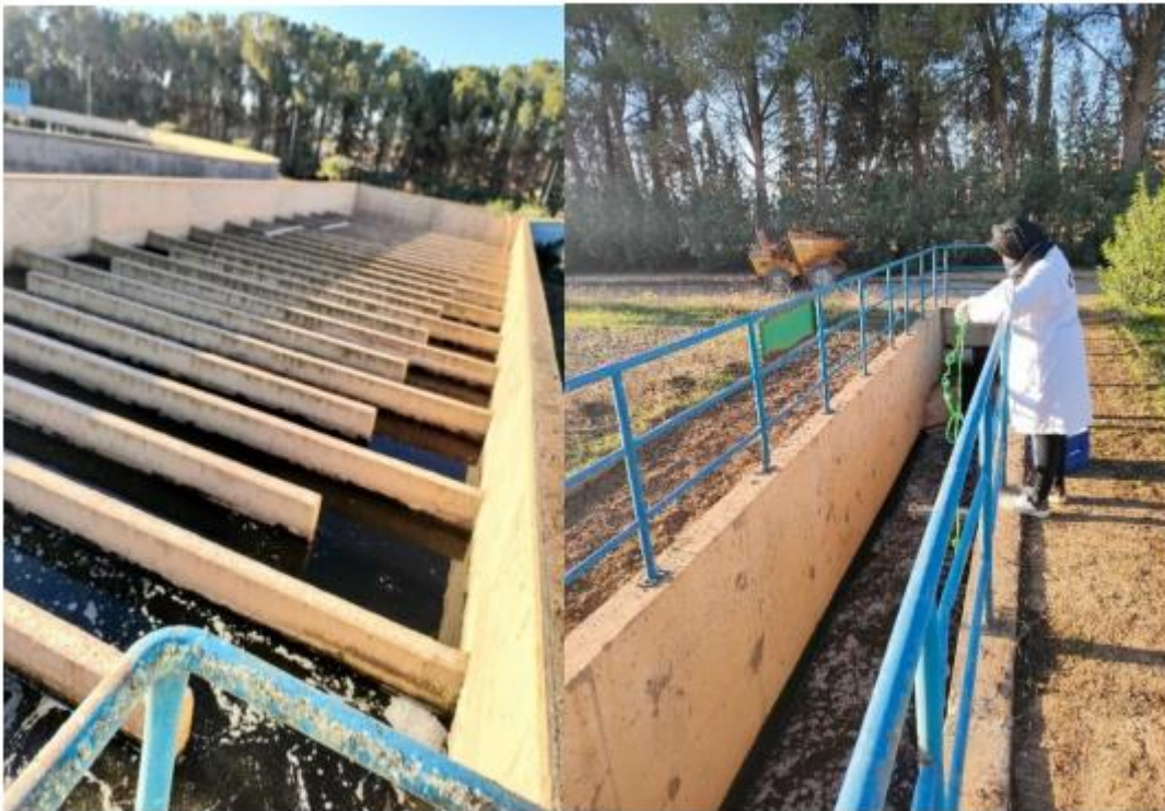
Fig. 08 : Bassin de chloration (Station de Saida : Janvier 2022)
