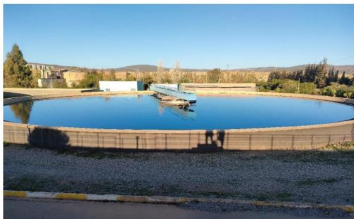
Fig. 05 : Décanteur secondaire (Station de Saida : Janvier 2022)
